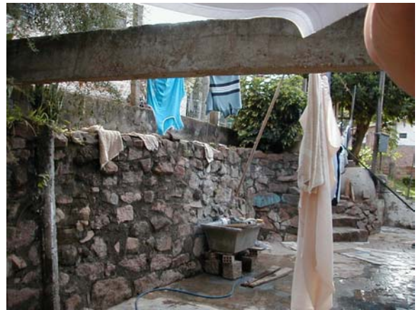
Foto 08: km 0+090 LD muro de pedra existente em frente casa 347. Local com previsão de muro de contenção (Muro 02).
