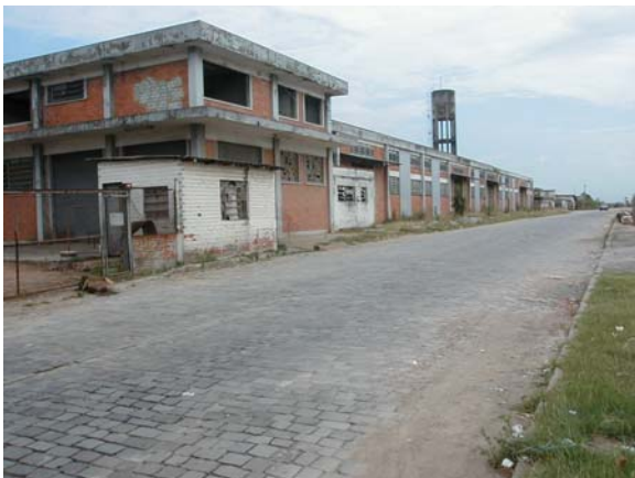
Foto 03: km 0+020 (LE). Pavilhão (depósito) abandonado. Calçamento existente (paralelepípedo) com vários afundamentos localizados.
