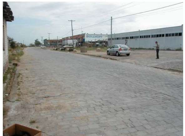
Foto 04: km 0+040 (LD). Passeio do lado direito é utilizado como estacionamento. Notar defeitos na superfície do calçamento.
