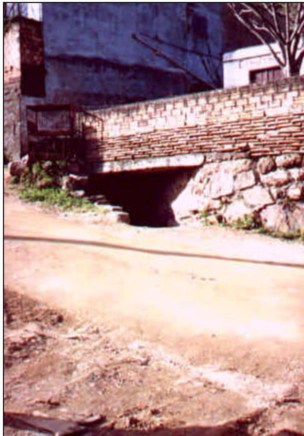
Foto 6: Vista da Galeria localizada na estaca km 0+130, que atravessa a rua Santa Maria e está ligada à descida d'água.
