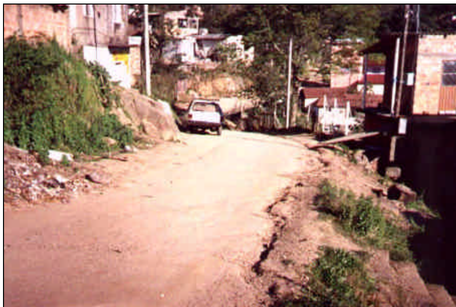
Foto 12: Vista parcial entre as km 0+180 e km 0+200 da rua Santa Maria mostrando a esquerda matacões de grande diâmetro.
