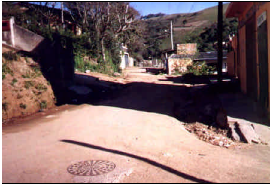
Foto 16: Vista parcial da rua Santa Maria entre os km 0+250-km 0+290, vendo-se a esquerda talude solo saprolítico e, logo após, também a esquerda, a rua Santa Tereza. A direita, em frente ao tampão de ferro fundido do DMAE está a rua Santa Tereza. Os eixos da rua Santa Tereza, a direita e a esquerda da rua Santa Tereza, estão defasados em torno de 15m.
